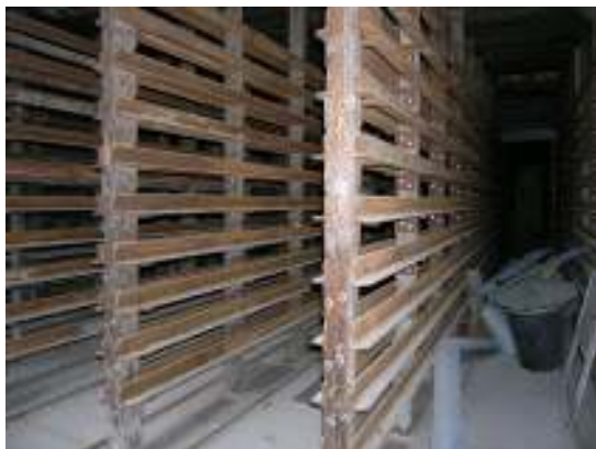
Torkanläggning ovanför kammarugnarna.
