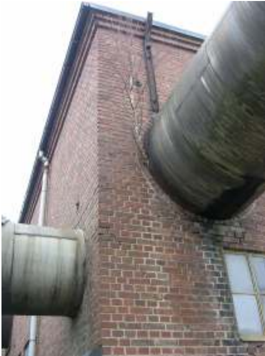
Flera av fasaderna är idag i dåligt skick.
